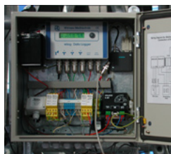
0903-44-OP306 mit wilog306 , GSM-Modem und solarer Strom- versorgung 0903-44-OP306 with wilog306 , GSM modem and solar power supply
